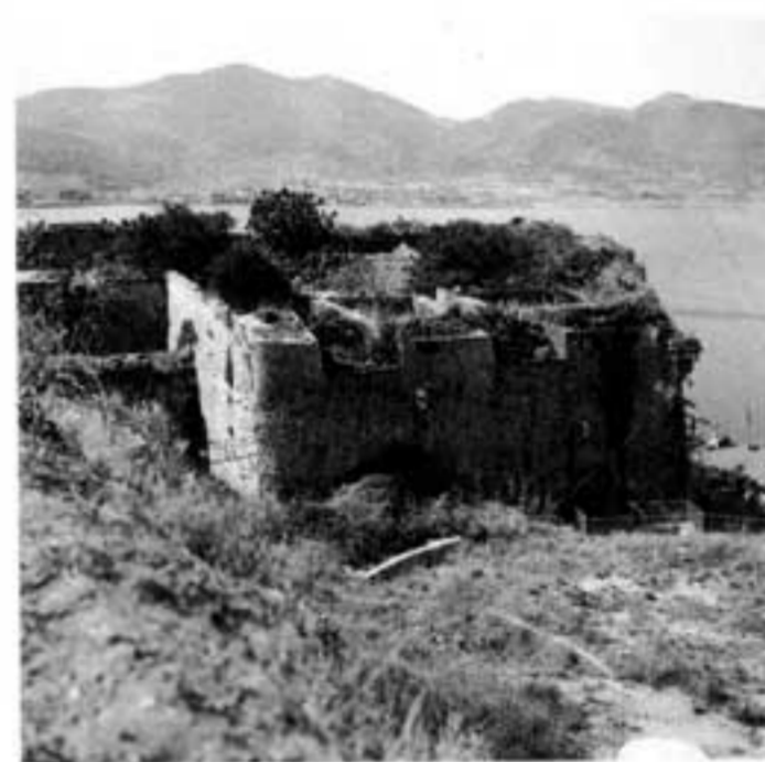
Fianco nord ("musone") del Bastione delle Palle di Sopra con le ampie troniere rivolte verso l'area antistante la Cortina degli Altesi ed il Bastione del Veneziano.
